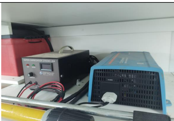
Inversor e Carregador de Baterias
