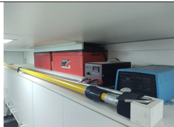
Inversor, Carregador de Baterias e Baterias
