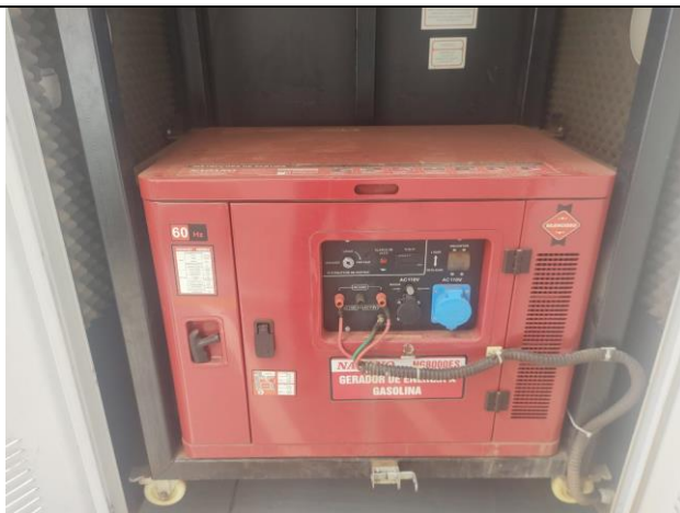
Gerador de energia
